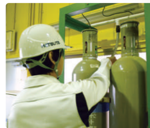
ガス系消火設備
