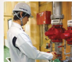
スプリンクラー設備(流水検知装置)
