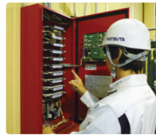
消火設備制御盤
