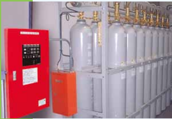
ガス系消火設備
