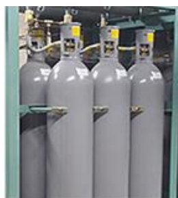
IG-541消火設備、二酸化炭素消火設備等 ガス系消火設備
