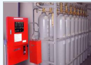
ガス系消火設備
