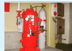
粉末消火設備
